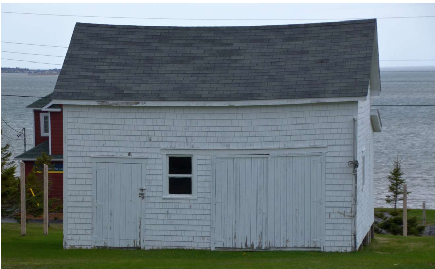
Beau bâtiment utilitaire qui présente un affaissement de la toiture nécessitant la remise d'aplomb de sa charpente; de même, au bas des murs, la proximité du revêtement avec le sol pourrait exiger quelques réparations au bardeau de bois et le dégagement du mur de façade pour en faciliter l'assèchement.
