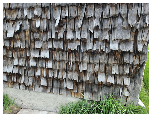
État d'un revêtement dégradé à remplacer
