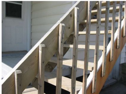
Modèle inapproprié et de mauvaise construction
